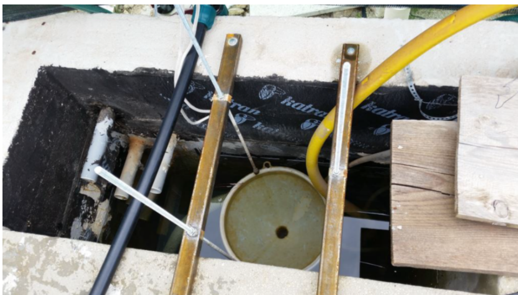
Slika 11: Preljev u nizvodnom rezervoaru.
